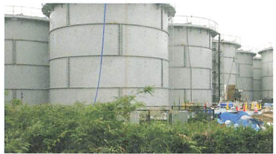
上:漏水した汚染水タンクを視察(2013年9月) 下:福島第一原発敷地に立ち並ぶタンク群
